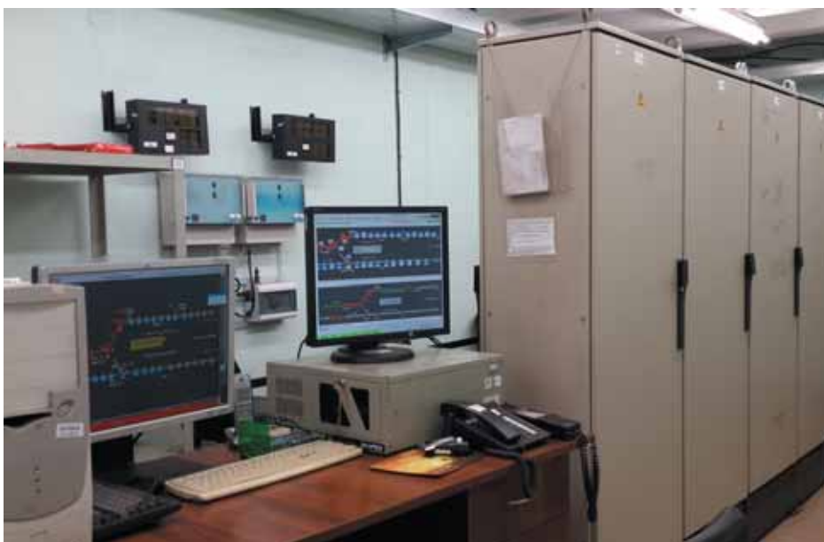
Рис. 2. Аппаратная АТДП, оборудованная системой «Движение» разработки НИИ «Точной механики», на станции «Международная»
