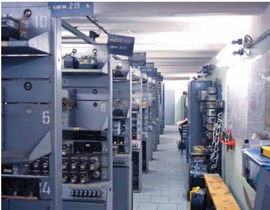
Рис. 1. Размещение оборудования в релейно-щитовой АТДП на станции «Приморская»
