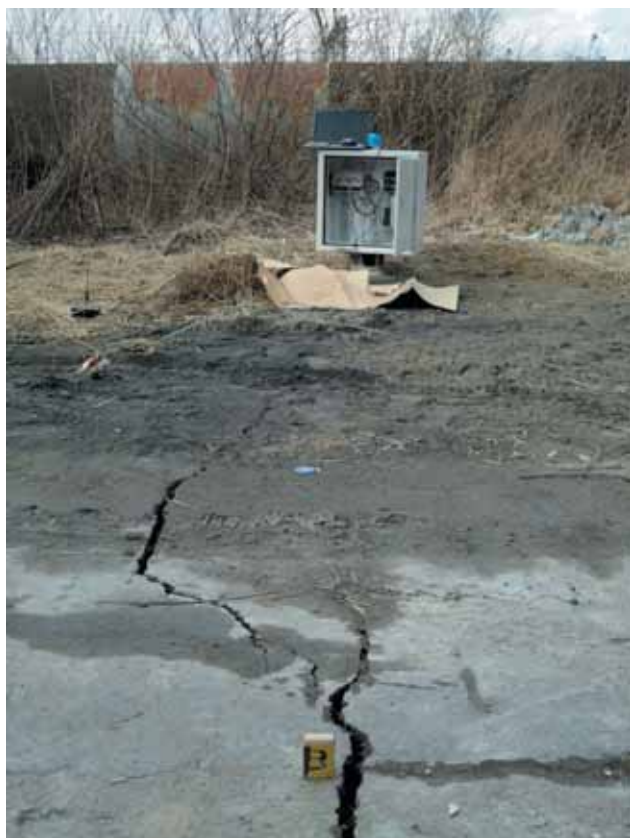
Рис. 4. Трещина на поверхности земли при выполнении нагнетания тампонажного раствора за отделку
